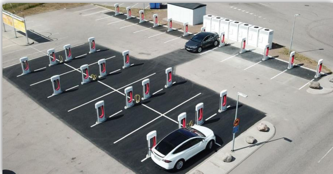
Teslas Supercharger-anläggning i Strömstad.
